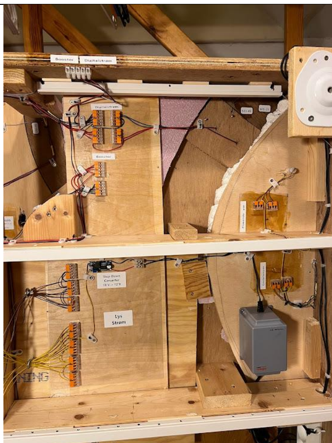
Modul 5 har egen transformator til Lysstrøm. Der er anvendt step-down converter – 18 v -> 12 v
